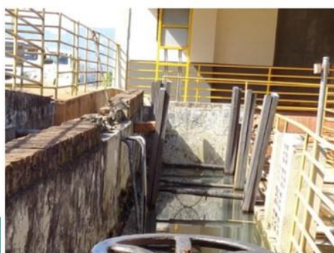
Figura 14: Detalhe para a parede do canal de chegada escorada e o tanque inundado Fonte: ARSAE (2019)
