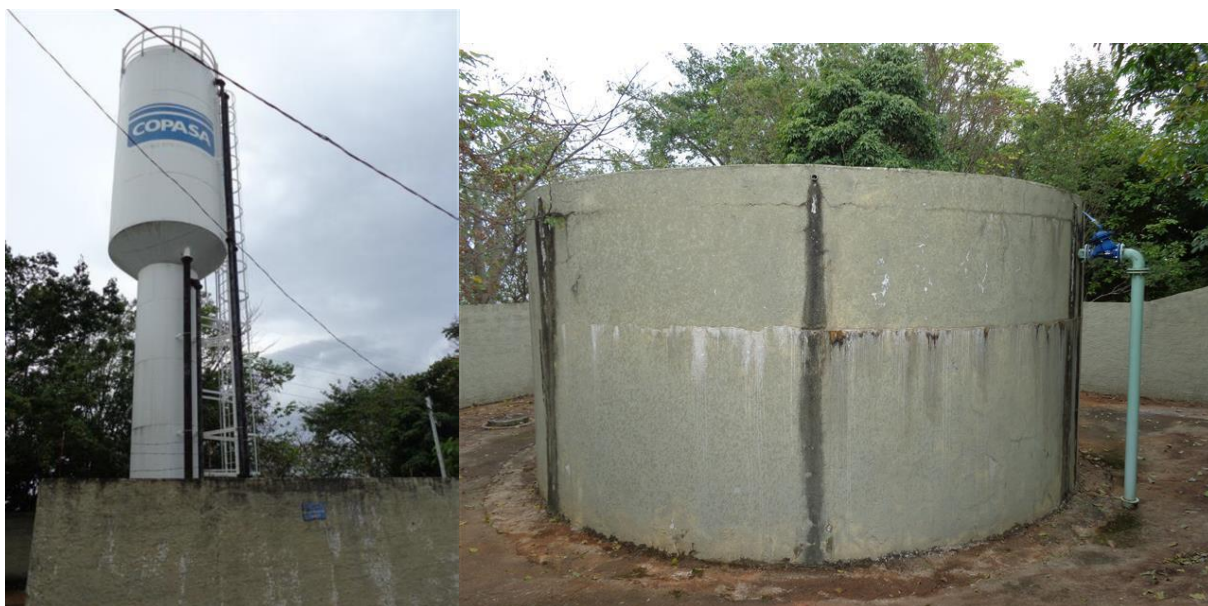
Figura 27: Reservatórios do Jardim Ipê
