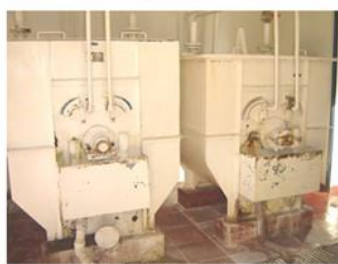
Figura 16: Dosadores de caneca Fonte: COPASA (2006)
