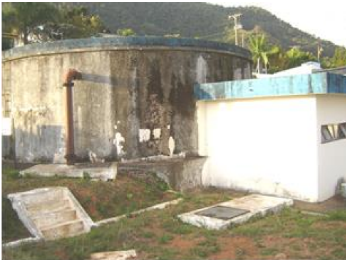
Figura 22: Vista do RAP 2 com 250 \text{ m}^3 e da EAT Zona Alta Fonte: COPASA (2006)
