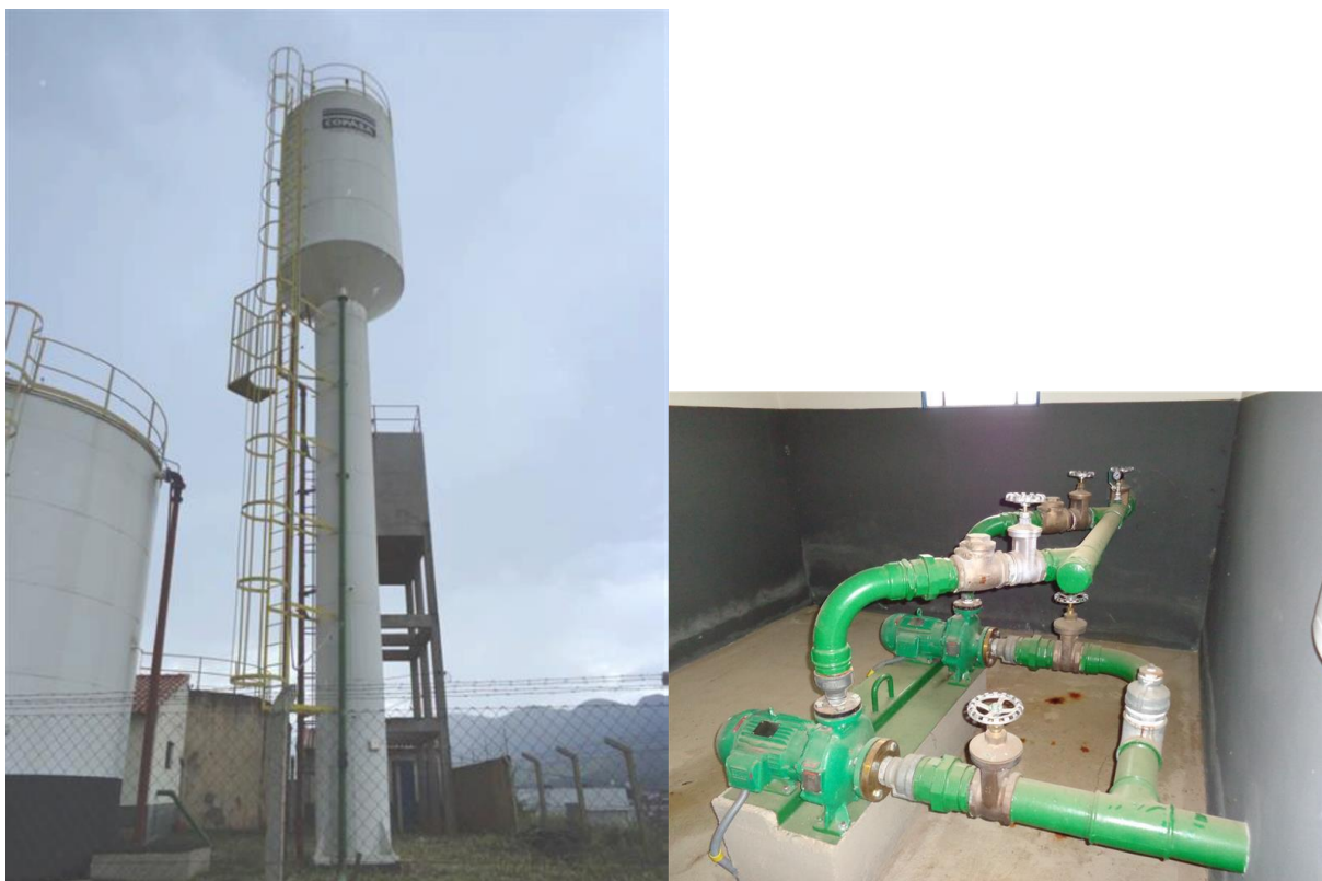
Figura 33: Reservatórios e EAT Mirante
