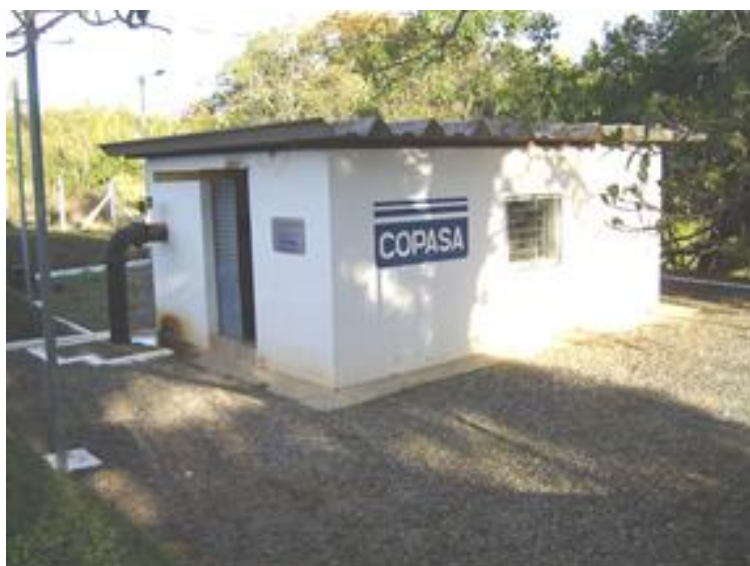
Figura 9: EAB de Alto Recalque (Externa)
