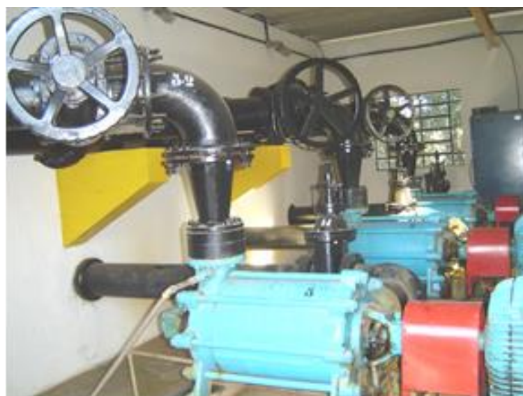
Figura 10: EAB de Alto Recalque (Interna)
