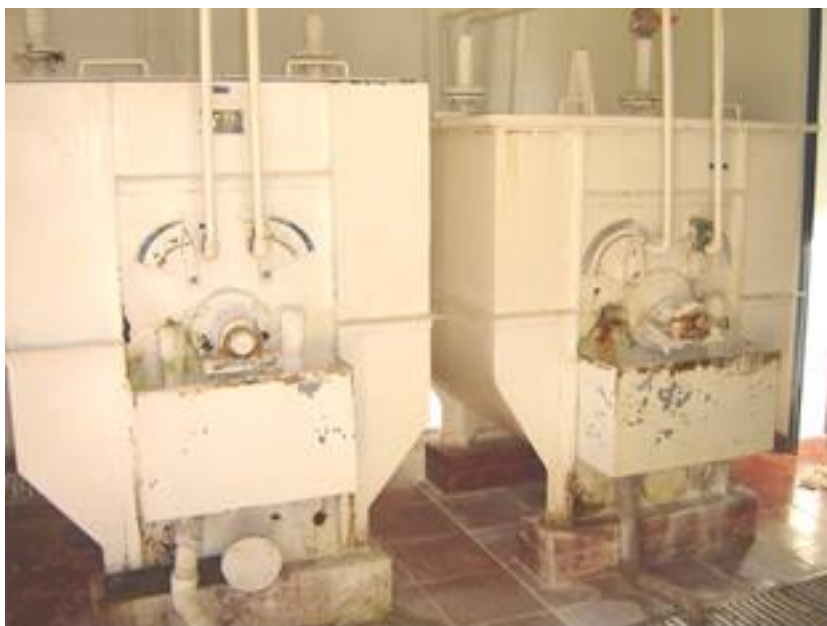
Figura 16: Dosadores de caneca Fonte: COPASA (2006)
