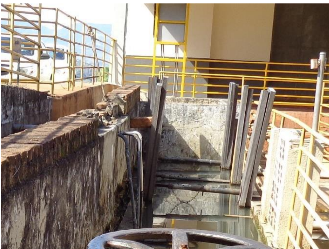
Figura 14: Detalhe para a parede do canal de chegada escorada e o tanque inundado Fonte: ARSAE (2019)
