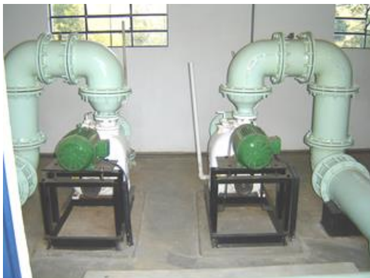
Figura 8: EAB de Baixo Recalque (Interna)
