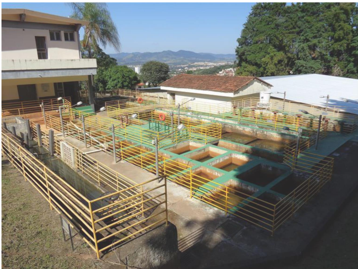
Figura 11: Estação de Tratamento de Água Convencional Fonte: ARSAE (2019)
