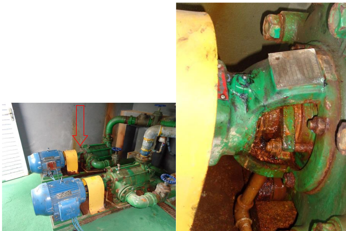
Figura 28: Detalhe dos conj. Motobomba do Booster Jardim Ipê, com excesso de vazamento na gaixeta da bomba
